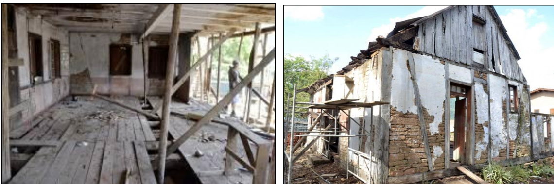
Figuras 26 e 27: Casa da Joaneta antes do restauro.
