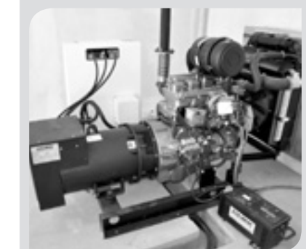
Geradores garantem energia em caso de falha no abastecimento
